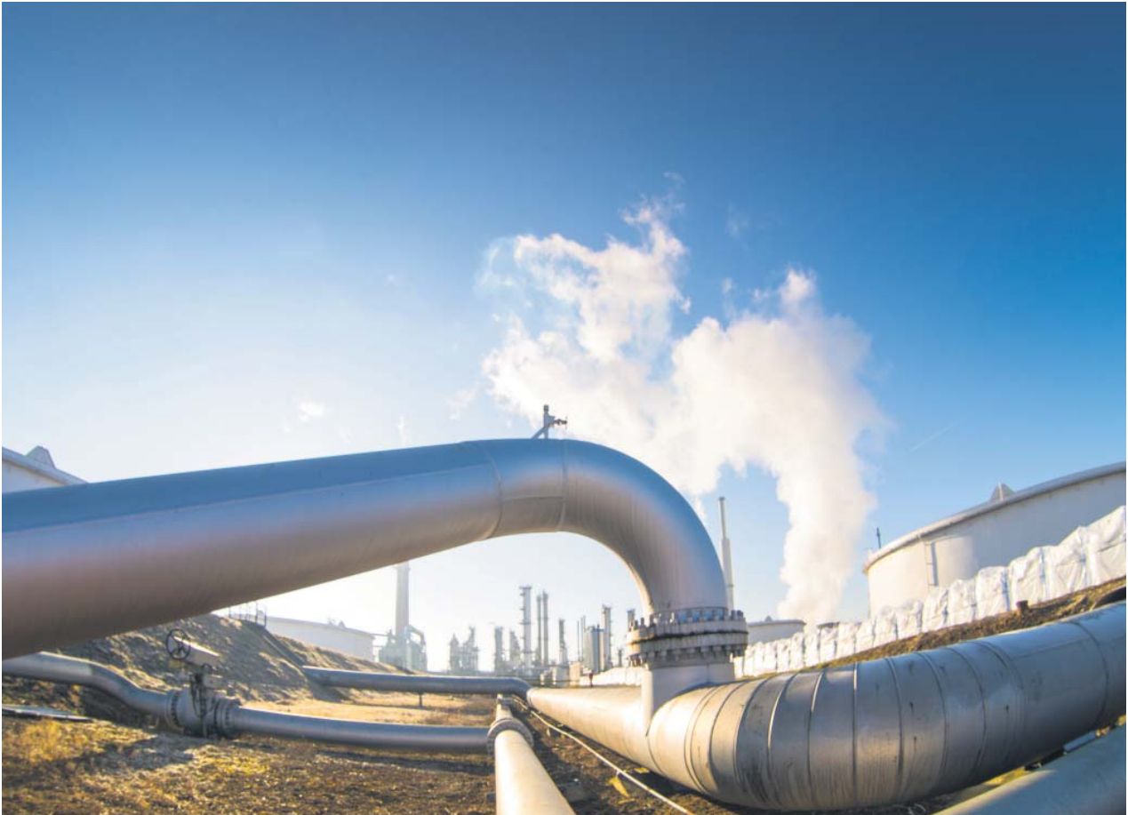
Blick durch den Rohrbogen der Rohölleitung
