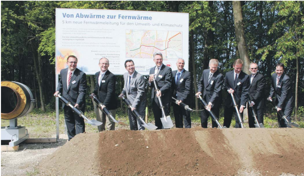
Spatenstich für das Fernwärmeprojekt. V. l.: Dirk Alsentzer (SWI Energie), Chester Kuchta (COO Petroplus), Karl Händel (SWI Netze), Gerhard Fischer (Raffinerieleiter), Hubert Stockmeier (SWI Netze), Dr. Alfred Lehmann (OB Ingolstadt), Matthias Brückmann (MVV Energie AG), Frank Dreves (Audi), Matthias Bolle (SWI Beteiligungen)
