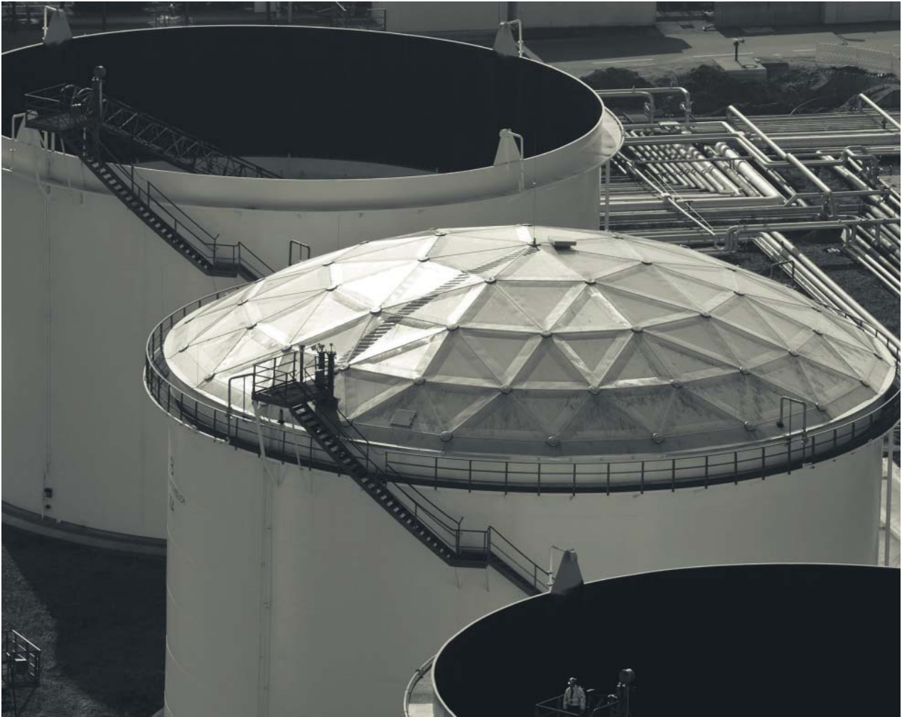
Tank für Bioethanol mit „Domdeckel“
